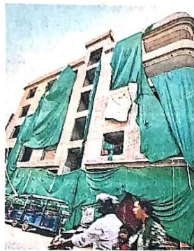
भेलपुर में सील अवैध निर्माण में चोरी-छिपे जारी था निर्माण। स्रोत: वीडिए
